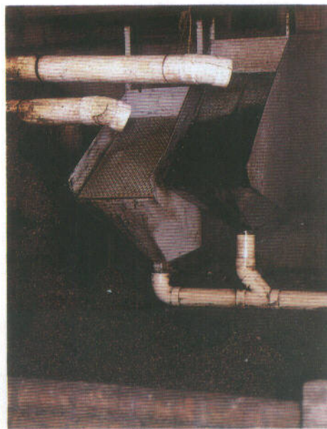
Separadores utilizados en una fosa. Se observan los tubos de descarga (superiores) y de retorno de agua (inferiores).
