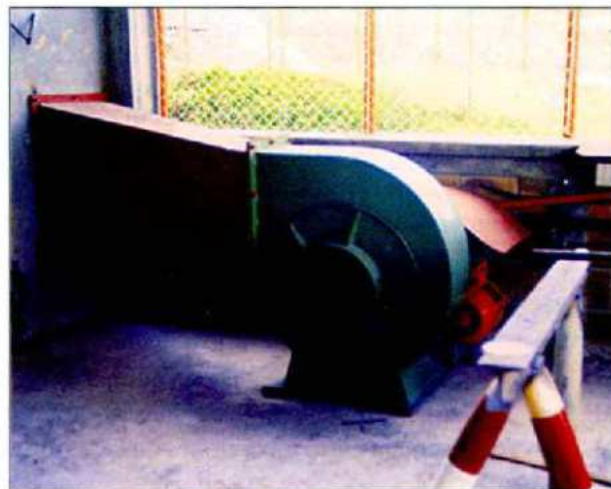
Figura 95. Ventilador centrifugo forzando aire a un silo-secador CENICAFÉ. Obsérvese la correcta transición entre la salida del ventilador y la entrada al secador (el generador de aire caliente ha sido retirado).
