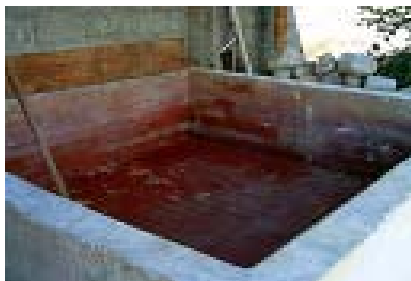
Tanque para la fermentación anaerobia
