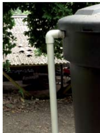
Figura 7. Tubería de seguridad para rebose de ARL.
