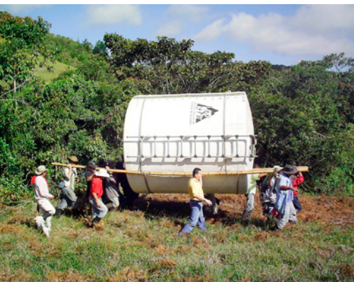
Construcción del acueducto de la vereda Nazareth, El Retiro, Antioquia, 2006. Archivo Fotográfico, Comité Departamental de Cafeteros de Antioquia.
