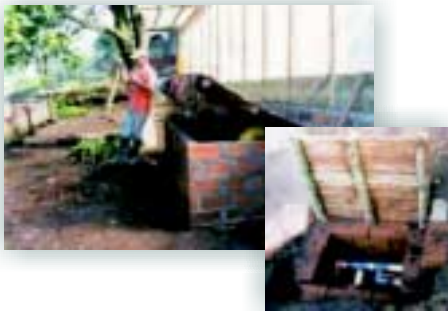
Figura 7. Unidad de Control de Insolubles. Desagües y válvulas para control de salida de fluidos.
