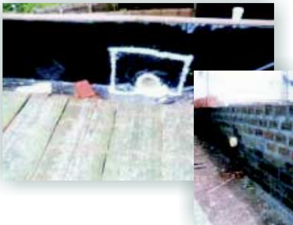
Figura 3. Salida de lixiviados y entrada de aire seco a través de tubería PVC 6"
