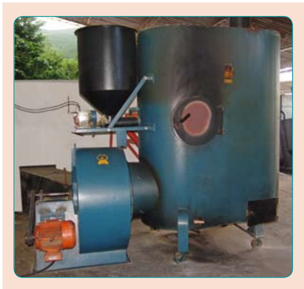
Figura 6. Intercambiador de calor III
