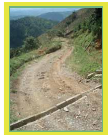
Figura 13. Disipadores de agua.
