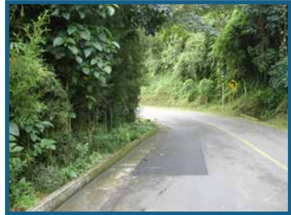
Figura 8. Estado actual de proceso de restauración de movimiento masal sobre la vía que conduce a Cenicafé Planalto (1999 – 2011).
