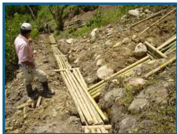
Figura 4. Sistema de drenaje con filtros vivos en espina de pescado, para evacuar aguas subsuperficiales en suelos originados de conglomerados, altamente saturados.
