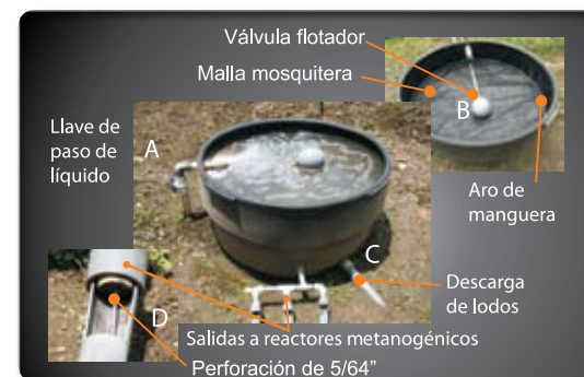
Figura 25. Conexiones en la recámara dosificadora.
